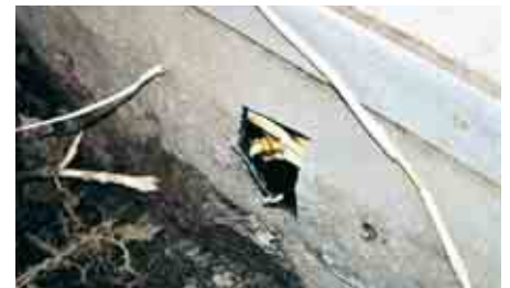
Bereits durch die Abdichtung gewachsene Bambusrhizome
