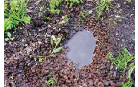
Die Dränfunktion dieser „Dachbegrünung“ ist offensichtlich unzureichend...
