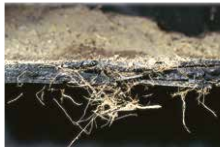
Eine von Wurzeln durchdrungene Bitumenabdichtung ohne Wurzelschutzausrüstung.
