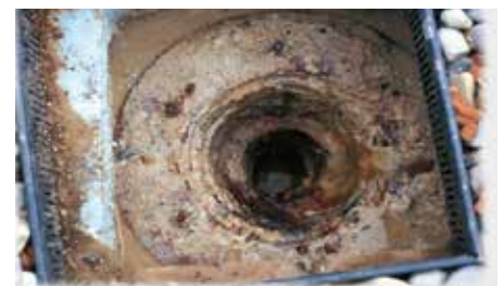
Schutzschichten aus Beton bergen das Risiko der Versinterung der Dachabläufe. Mit Schutzlagen aus Synthesefasern oder Kautschuk kann dies verhindert werden.
