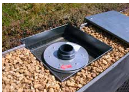
Das Drosselement liegt geschützt unterhalb des Kontrollschachts und reguliert den langsamen Wasserabfluss. Es fungiert gleichzeitig als Überlauf.
