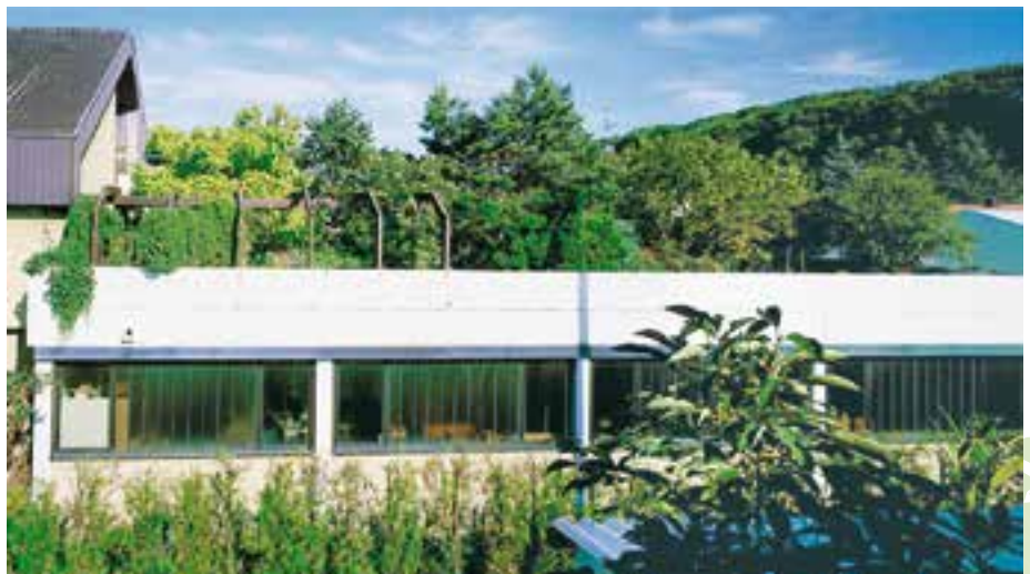
Eine Dachbegrünung, die viel zu dicht angelegt wurde.
