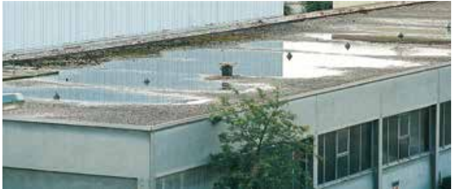
Flachdächer zeigen häufig – obwohl mit Gefälle geplant – Pfützenbildung! Darauf muss bereits bei der Planung geachtet werden.
