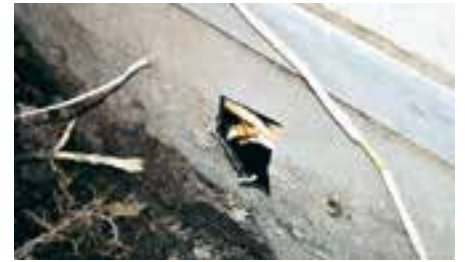
Bereits durch die Abdichtung gewachsene Bambusrhizome
