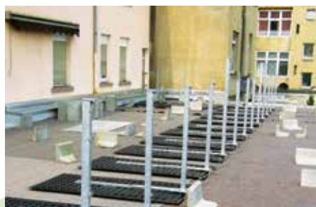
Nach Aufbringen einer Schutzlage über der Dachabdichtung werden die Geländerbasen GB/GB-Eck ausgerichtet und die Pfosten sowie ggf. die Halter für die Anschlagsschiene montiert.
