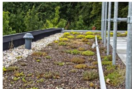
Für Pflegearbeiten im Dachrandbereich wurde vor dem Geländer das Fallnet® GB 200-Rail Schienensystem angebracht.
